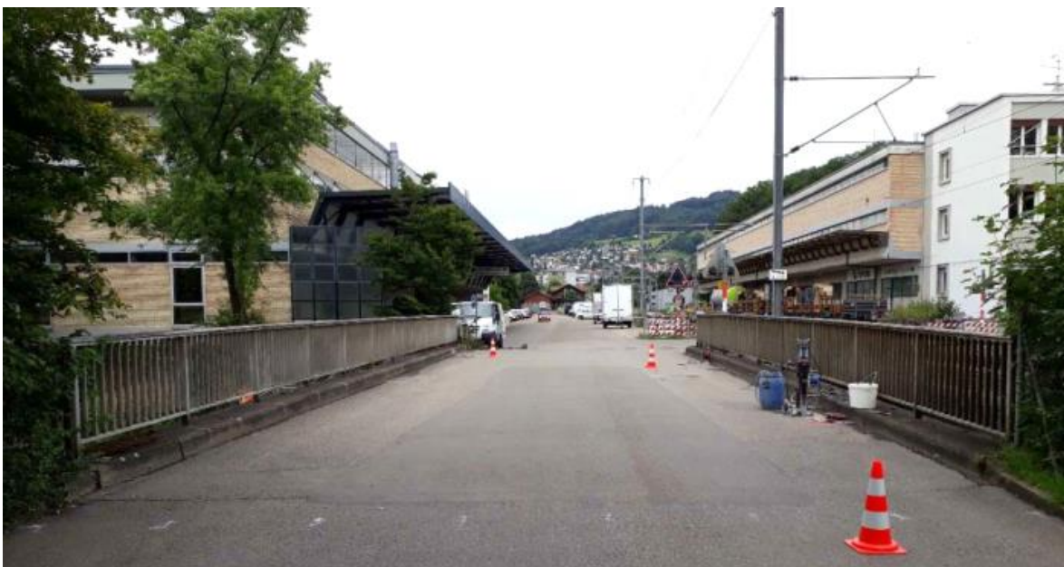
Abb. 2 (Blickrichtung Bahnhof Weissenbühl): Ansicht der Brückenoberfläche.
