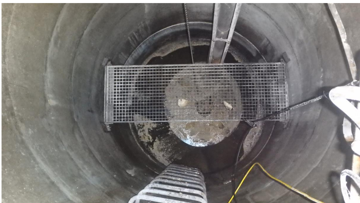
Abbildung 3: Pumpensumpf: Betonschäden, korrodierte Bewehrung, Podest korrodiert/nicht SUVA-konform
