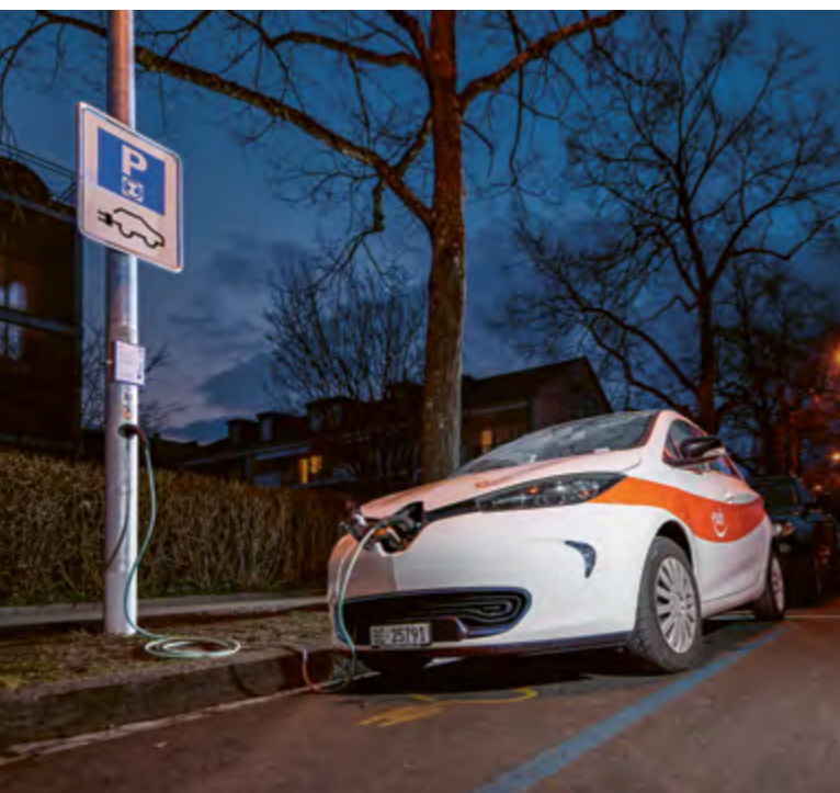
Laden eines E-Fahrzeugs an einer Strassenlaterne
