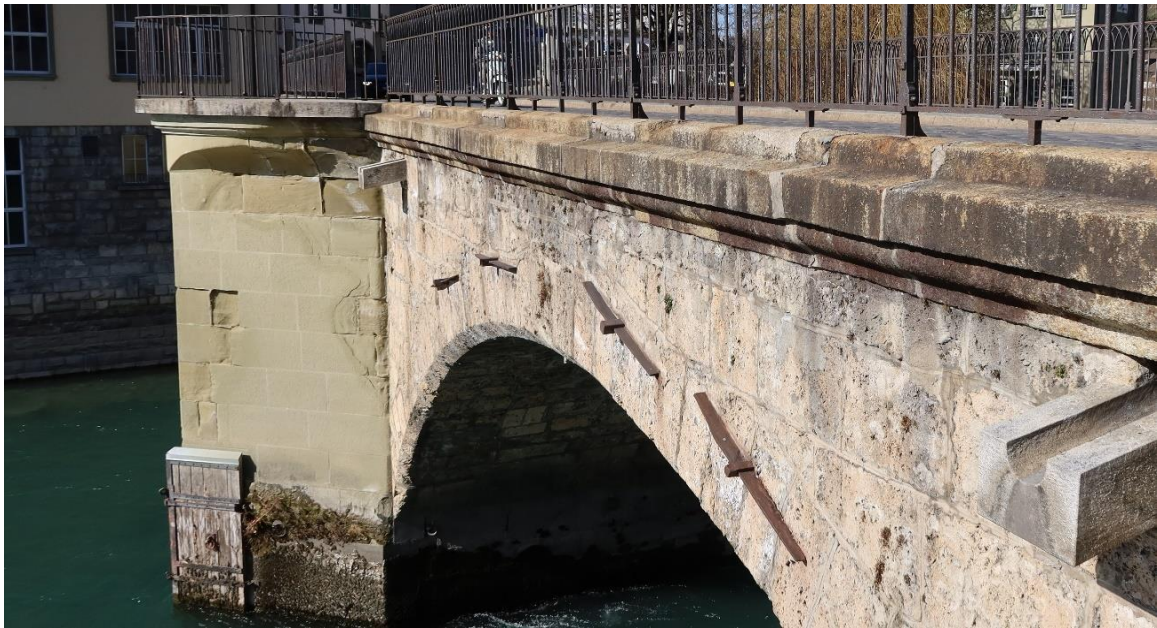
Abb. 5: Schadhafte Mauerwerk, Risse und Ausbrüche der Steine
