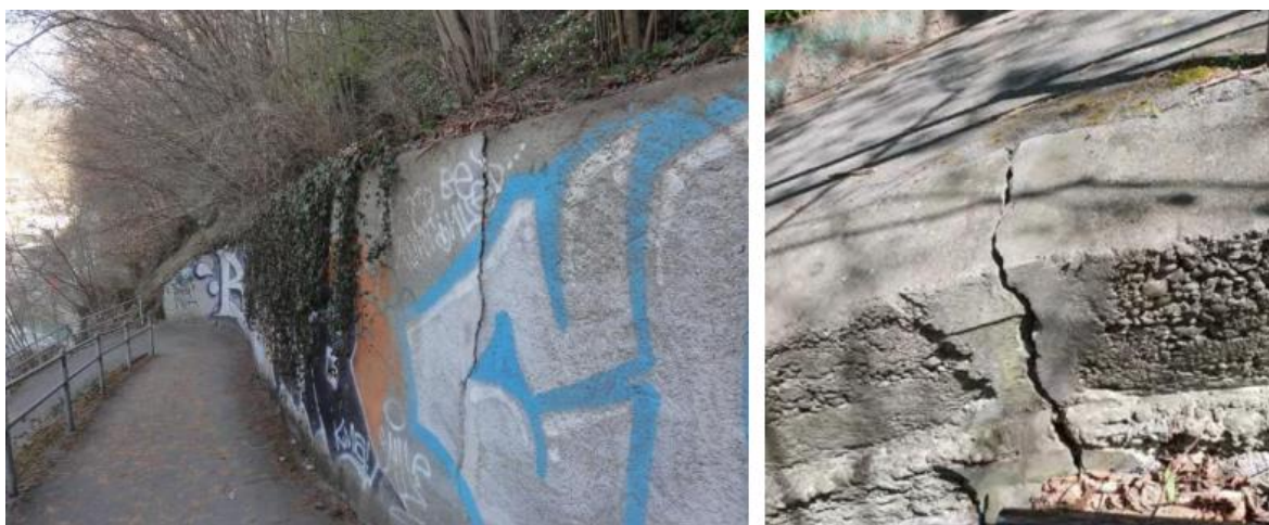
Abb. 15: Stützmauern mit Verschiebungen und Rissen
