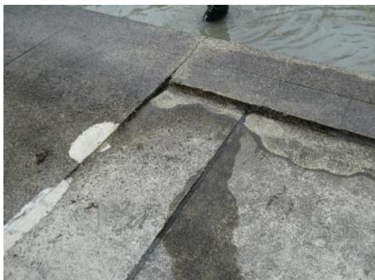
Abb. 6: Stolpergefahr bei Zugang Becken
